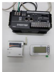
電力監視システム
